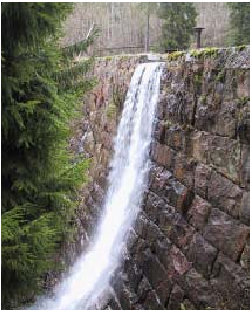
Byggingen av Sankedammen må ha vært et stort arbeid for 100 år siden. den ligger til i ulendt terreng uten vei. Det må ha vært et stort slit både for folk og hester å frakte de store steinblokkene opp den provisoriske veien som ble anlagt
