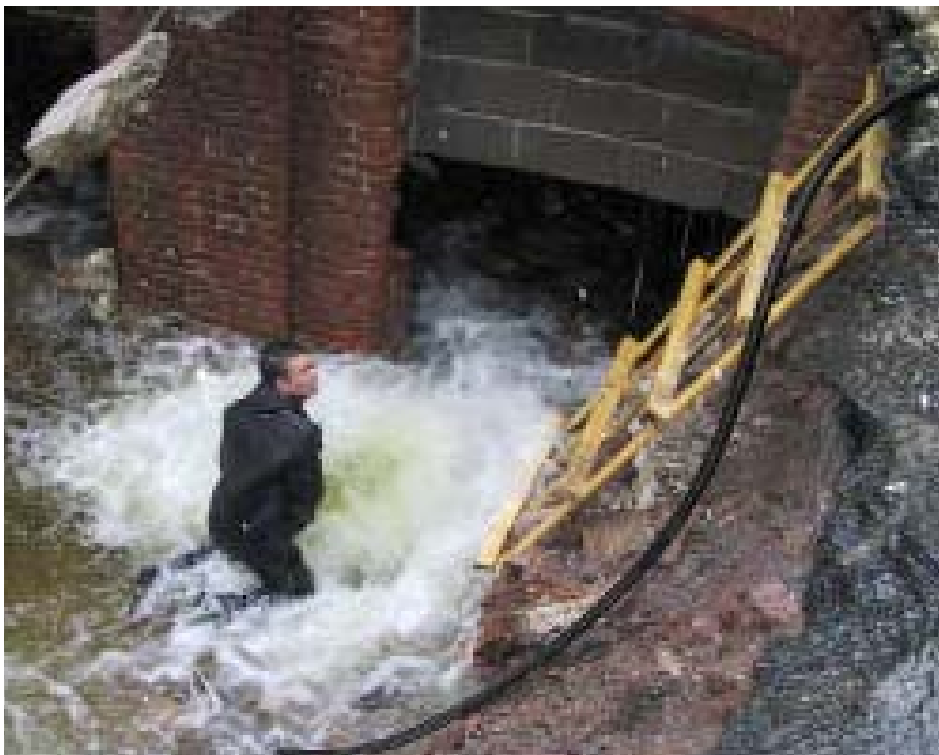
Froskemann i gang med å stake opp kulverten under fabrikken under flommen i 2000. På dette tidspunktet flommet vannet tvers igjennom underetasjen i fabrikkbygningen
