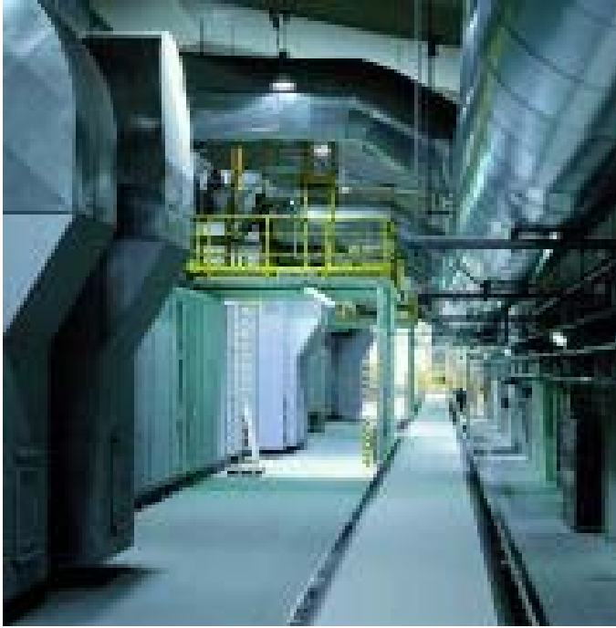
Det er dimensjoner over Norgipsfabrikken i Opole, totalt er produksjonslinja 500 m lang.
